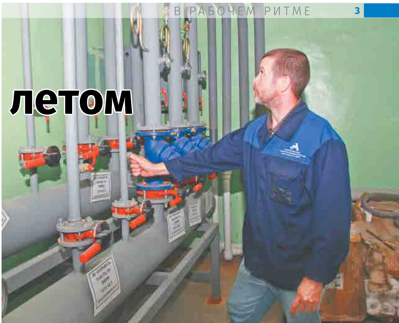
Мастер теплосантехнического участка ОГЭ Олег Головкин проверяет выполненные работы на тепловом узле в корпусе №22. Здесь заменены запорная арматура, воздушники и краны-спускники систем отопления.
